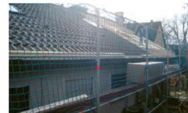
3 Korrekt anstelte Dachdeckerschutzwand mit Aufhängesatz.
